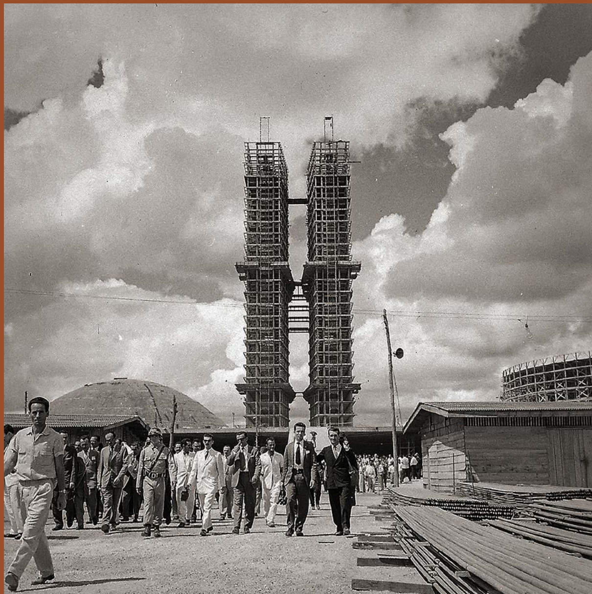
Obras de construção do Congresso Nacional, Brasília - Esplanada dos Ministérios, em registro de 1959.
